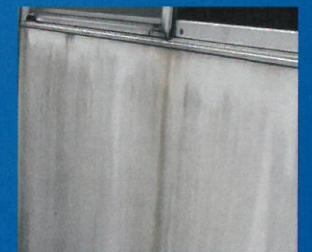
外壁のくすみ
